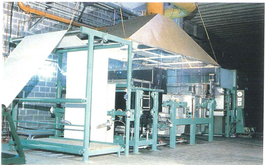
Abb. 1: Ammoniak-Veredlungsanlage für Gewebe und Maschenware
